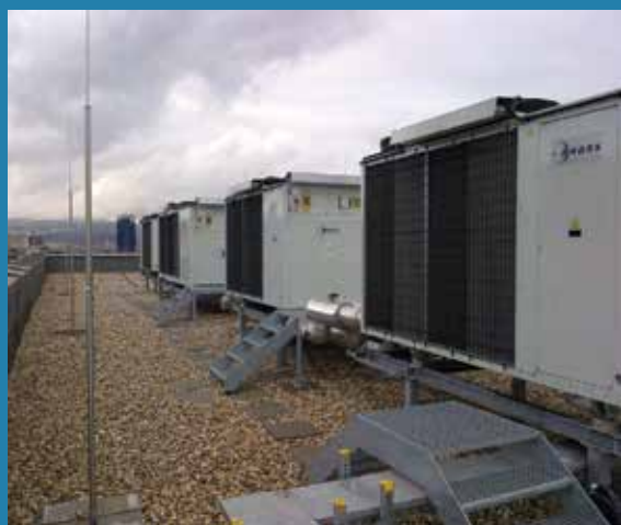
Aplicación industrial - AUSTRIA
