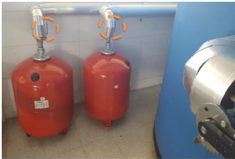
Estanques de expansión
